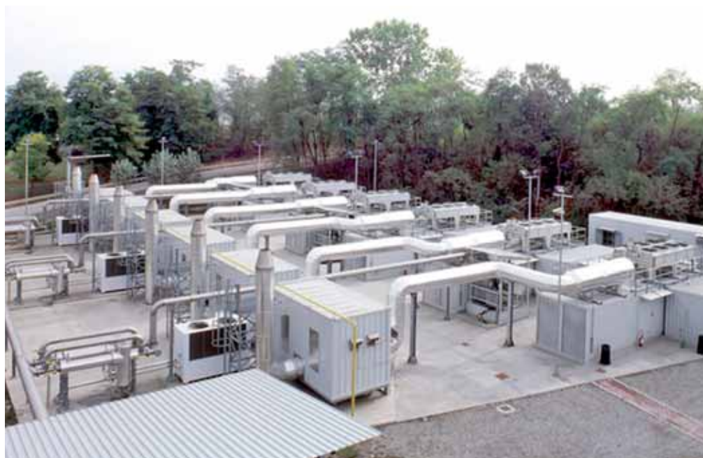
Sulla sinistra sono visibili più sistemi di trattamento con prodotti Parker Hiross disposti in parallelo.
