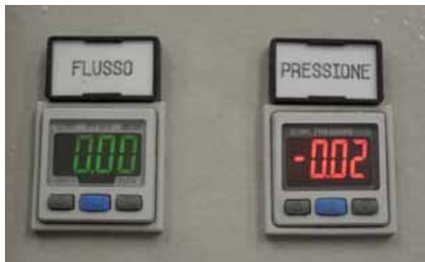
Particolare della stazione di collaudo con pressostati e flussostati digitali SMC.
