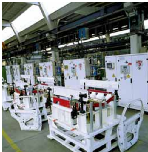
Un impianto per il riscaldamento di portiere di automobili.
