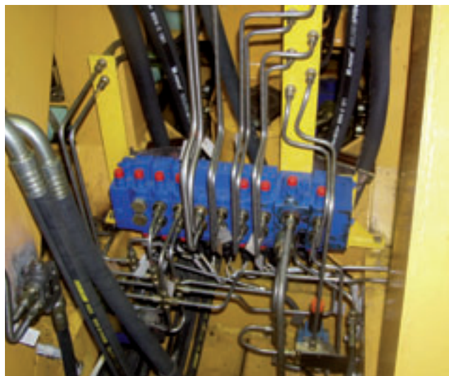
4. Valvole del blocco di controllo M4.15. I sistemi di azionamento e controllo utilizzati nei moduli macchina sono realizzati con componenti e unità di controllo idraulici Rexroth.
