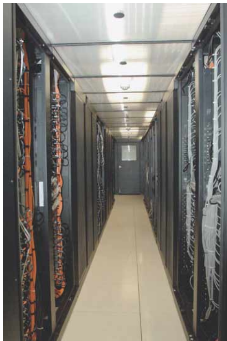
Zona del data center Ferrari fornito e installato da Apc.
