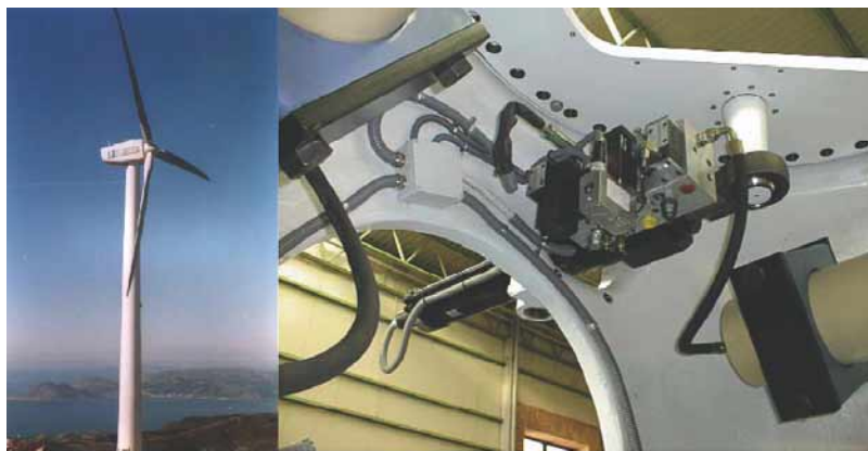
7. Controllo del passo dell'elica di una turbina eolica.
