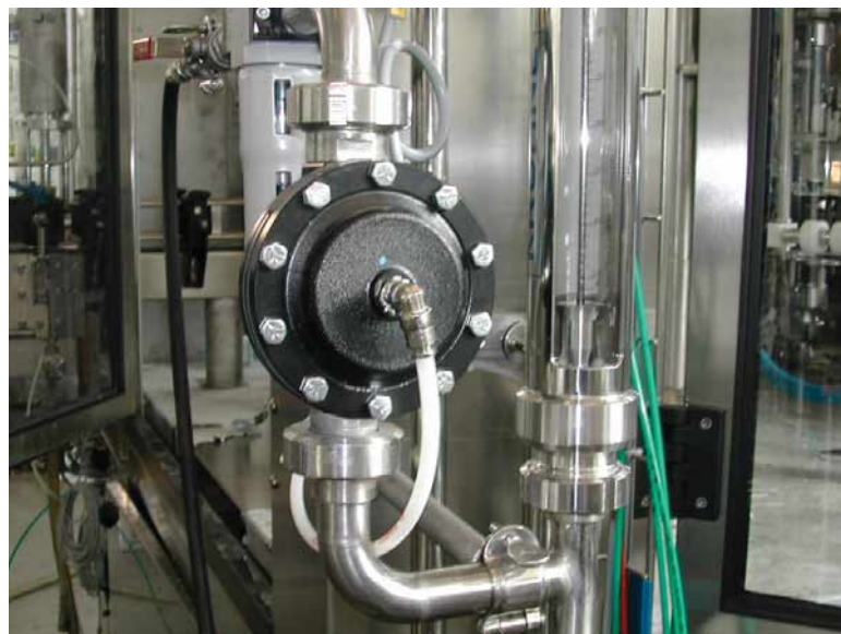
Riduttore di pressione per anidride carbonica installato su una macchina per l'imbottigliamento di birra.
