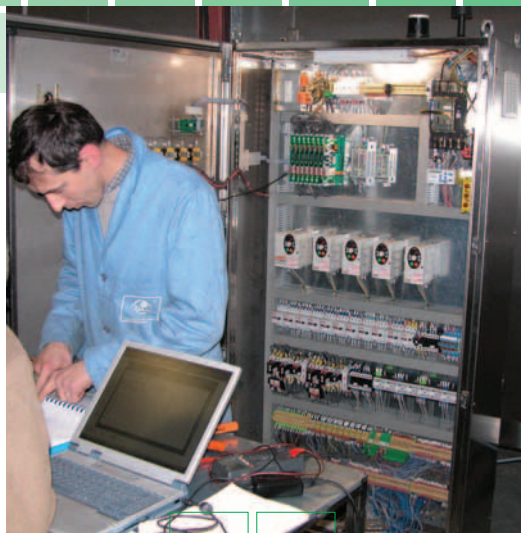
L'armadio elettrico per la gestione del tunnel.
