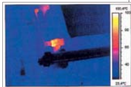
4. Pericolo d'incendio determinato dal surriscaldamento di un componente meccanico. L'asta registra infatti in alcuni punti una temperatura superiore ai 100 °C.
