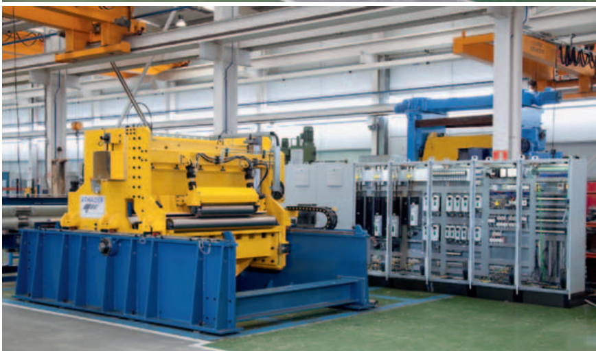
Nelle sue linee di produzione per la lavorazione dei metalli in bobine la Athader ha scelto di utilizzare soluzioni a velocità variabile di Control Techniques, società del Gruppo Emerson.
