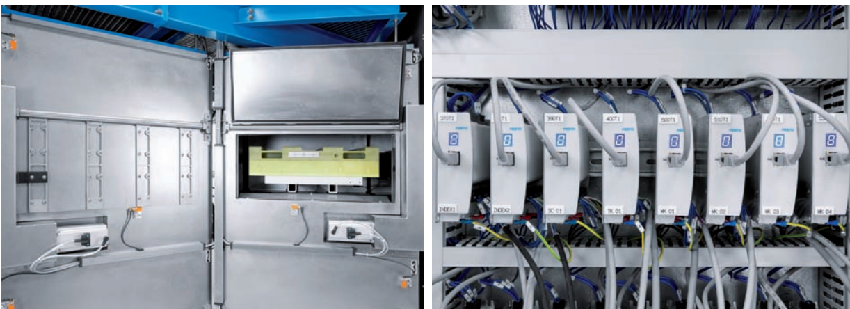
Componenti Festo: i motori passo-passo Emms-ST aprono e chiudono i box del sistema di formatura; i controllori Cmmo-ST in armadio di comando; il cilindro elettrico Dnce impiegato per sollevare un sistema di trasporto che convoglia le batterie al sistema di formatura.
